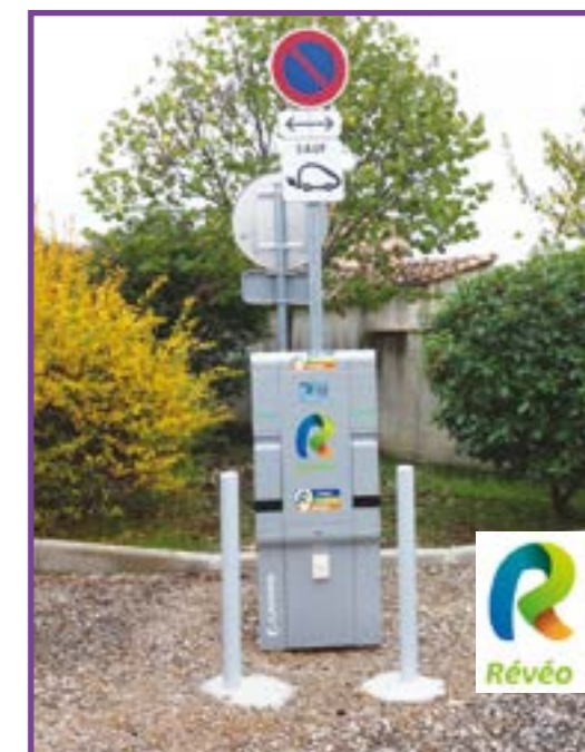
La borne de recharge située
