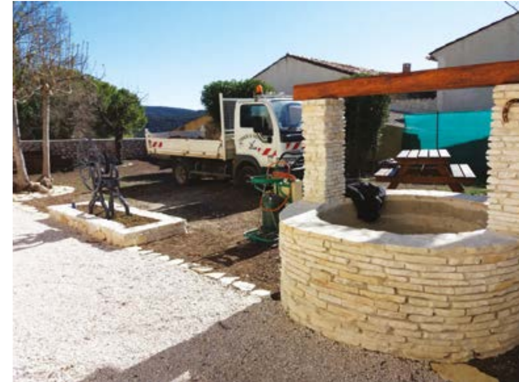
La cour du Presbytère a été entièrement rénovée grâce aux services techniques, qui ont réalisé un travail de qualité
